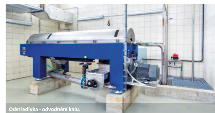
Odstředivka – odvodnění kalu.
