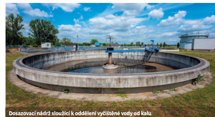
Dosazovací nádrž sloužící k oddělení vyčištěné vody od kalu.
